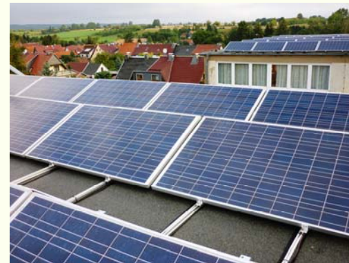
Einweihung der PV – Anlage Grundschule Vogtei in Oberdorla am 31.08.2010
